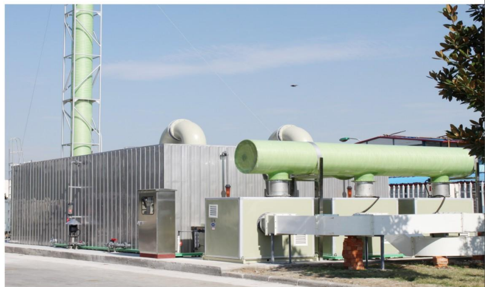
▲ 生物除臭装置
